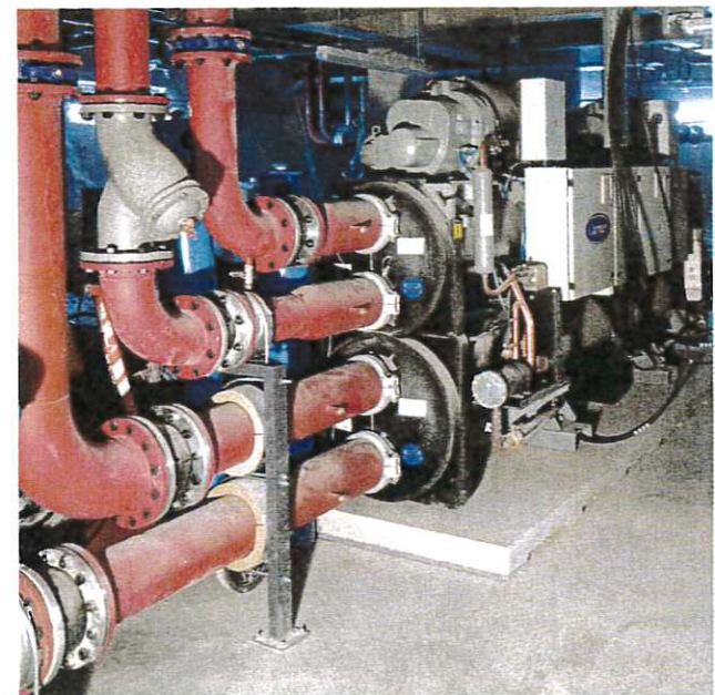
ROMAN COULATTE / EIFFAGE ENERGIE THERMIE
